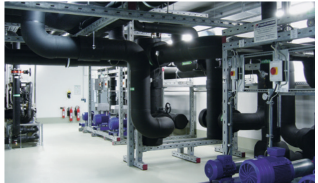
Kühlsystem betrieben mit Reinstwasser
